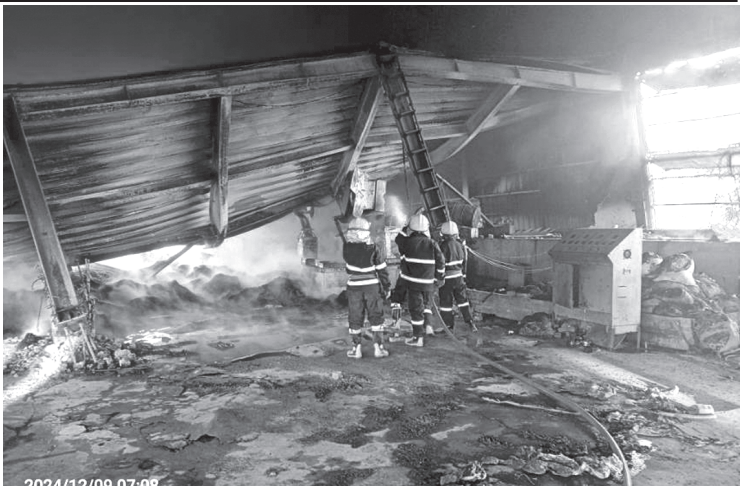
(၆၀×၂၀၀)ပေ၊ Steel Structure (၁)ထပ်အဆောက်အအုံ၏ (၆၀×၂၀)ပေခန့် မီးလောင်ခံရကြောင်း သတင်းရရှိပါသည်။
